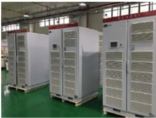
新风光 Wayside ESS
